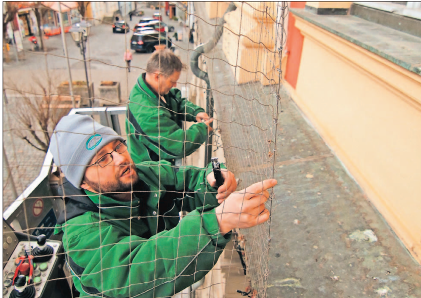
Damit künftig keine Tauben mehr in die Falle zwischen Netz und Rathausfassade gelangen, flicken Udo Sitorius (vorne) und sein Kollege Tino Winkler mithilfe eines Hubwagens einige Löcher. Foto: Stefan Blank
