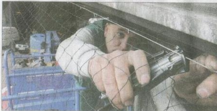
Täglich kontrollieren Mitarbeiter von APC die Netze, die unter Brücken angebracht sind. (Foto: Ohlig)
